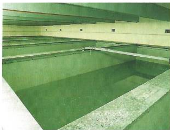
Bassin de filtration.
