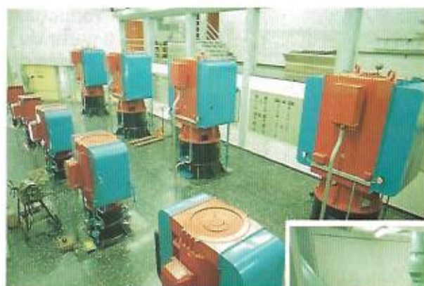
Station de pompage du Vengeron.
